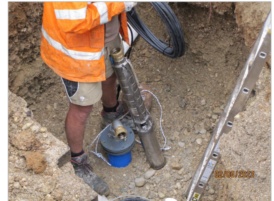
Pumpe mit Brunnenkopf
