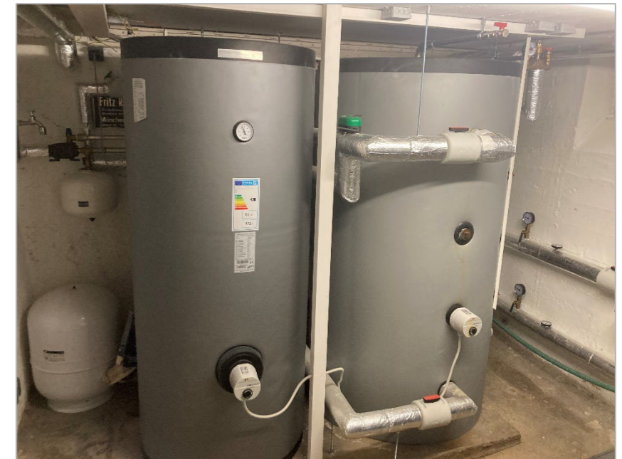
Boiler und Pufferspeicher
