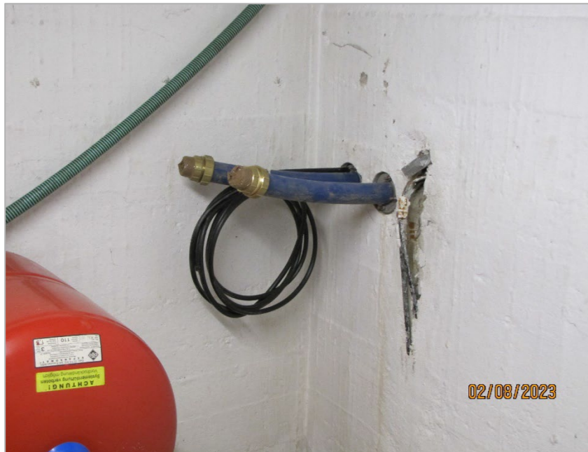
Hauseinführung im Keller
