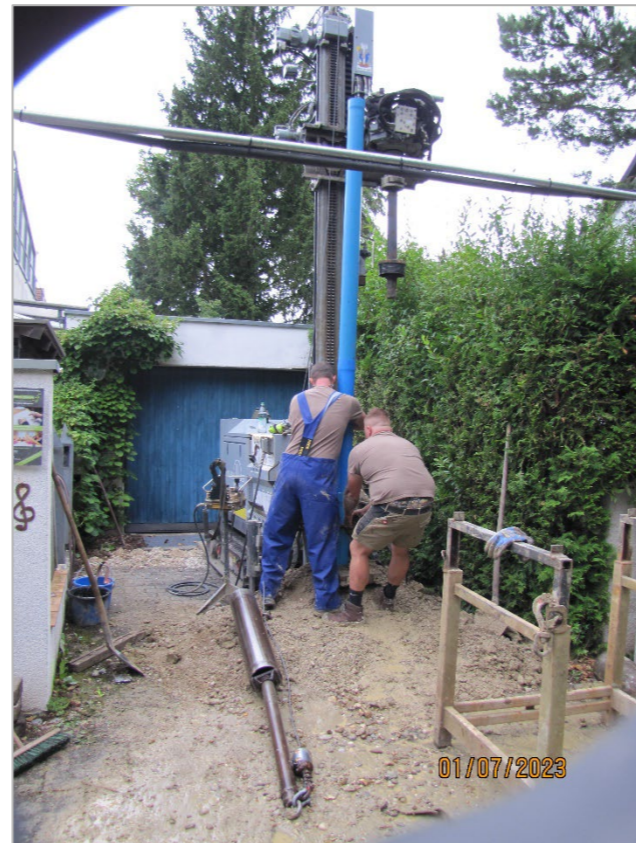
Verrohrung Förderbrunnen Ost
