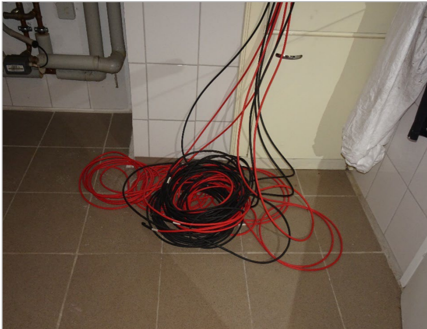
Leitungen im Keller Stand 2024
